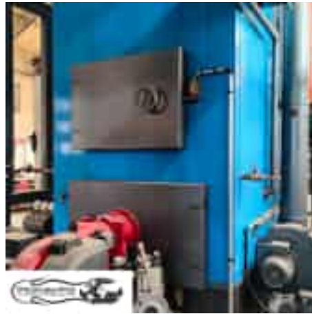
Przemysłowy kocioł grzewczy ZGP 700 - 1250 kW wewnątrz mobilnej kotłowni kontenerowej
