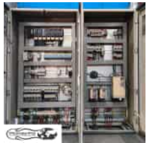
Szafa sterownicza i automatyka mobilnej kotłowni kontenerowej MAC 700 - 1250 kW firmy Płomex-Pol.
