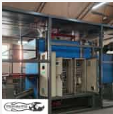
Mobilna kotłownia kontenerowa MAC o mocy regulowanej 700 - 1250 kW od Płomex-Pol z widoczną szafą sterowniczą i instalacją przemysłową.
